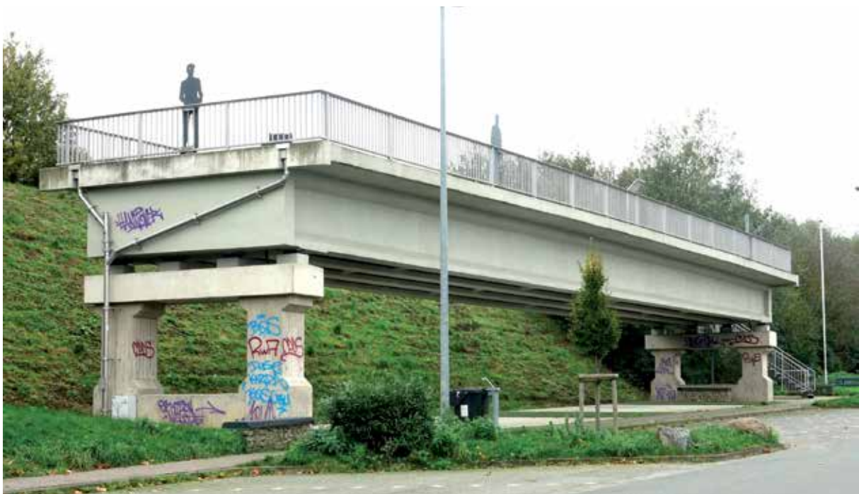
Bild 24 Die Träger der 1938 nach der Lizenz von Eugen Freyssinet in Oelde, Westfalen, hergestellten denkmalgeschützten Spannbetonbrücke fristen ein trauriges Dasein an einer einsamen Ecke einer Autobahnraststätte.
